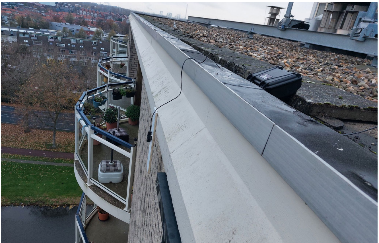
De batlogger en de microfoon zijn geplaatst aan de rand van het dak. The batlogger and microphone placed on the edge of the roof.
