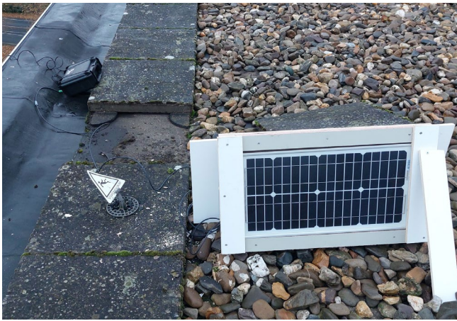
Stroomverziening wordt verzorgd door een zonnepaneel. Powersupply by a solar panel.
